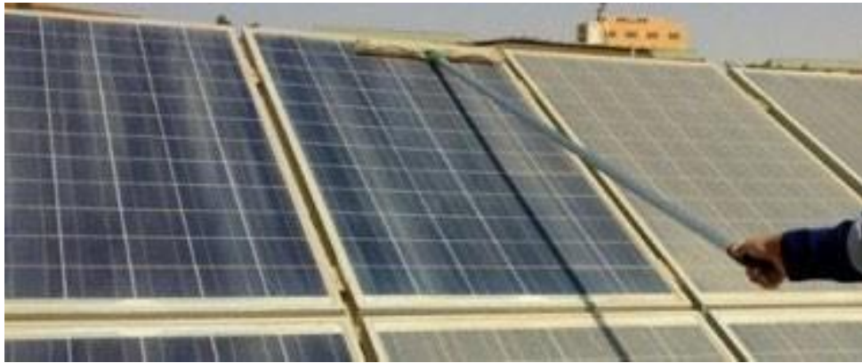
Figure 18 Exemple de dépôt important de poussière
