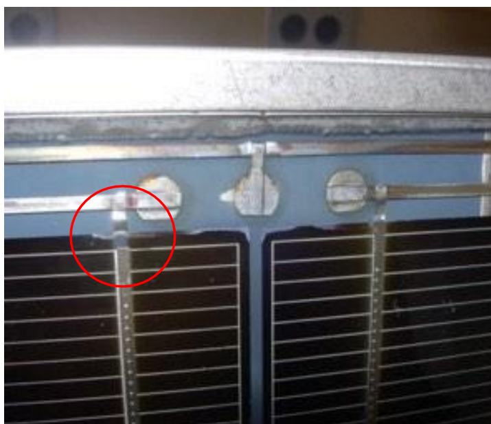
Figure 30 Rupture du ruban.
