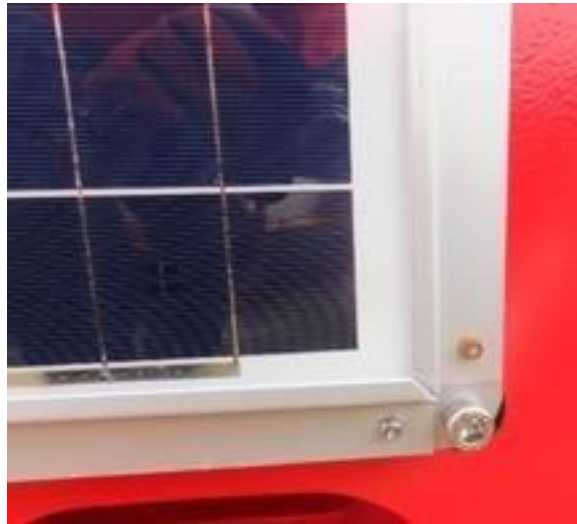
Figure 34 Corrosion du métal
