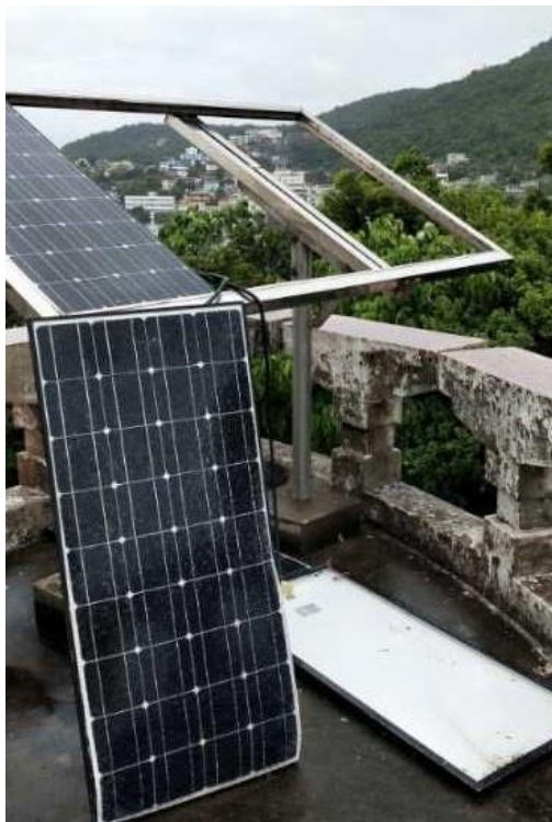
Figure 23 Exemple de modules solaires endommagés à la suite d'un super-typhon en Chine
