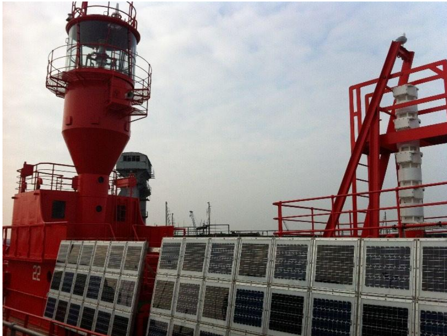
Figure 22 Exemple d'installation de panneaux solaires sur un bateau-feu
