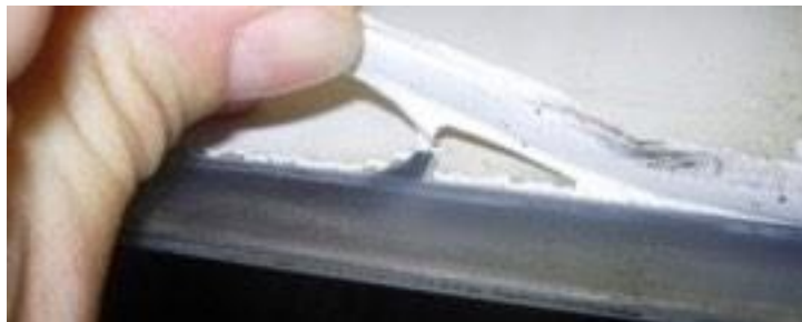
Figure 33 Exemple de défaillance de l'isolant
